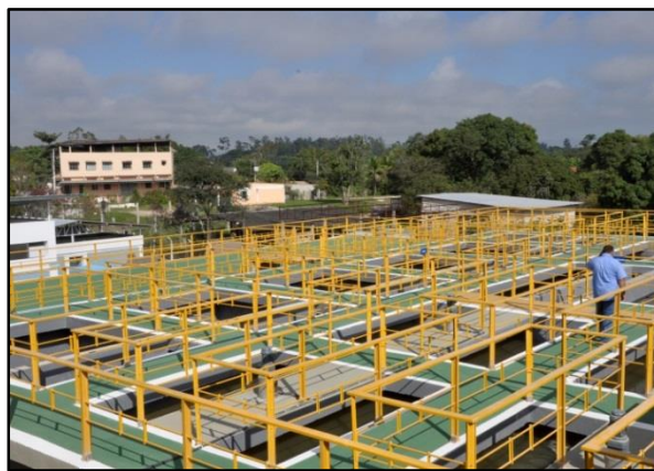
Figura 10 – Novo módulo da ETA Alegria
