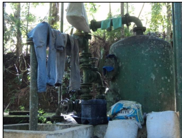
Figura 44 – Detalhe da unidade de tratamento.
