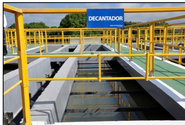
Figura 12 – Decantador do novo módulo - ETA Alegria
