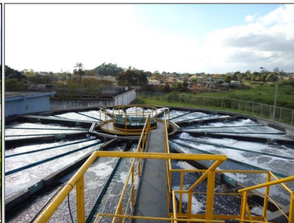
Figura 57 – Detalhe da unidade de tratamento.
