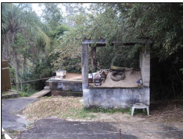
Figura 32 – Sistema de filtração e reservação do distrito de Pedra Selada
