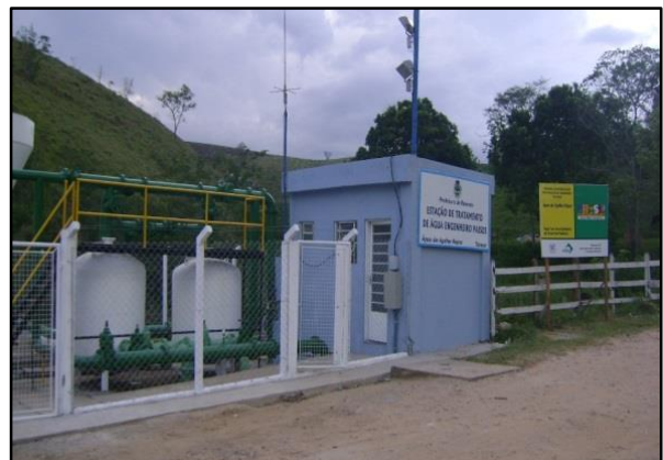
Figura 31 – Vista da ETA Engenheiro Passos
