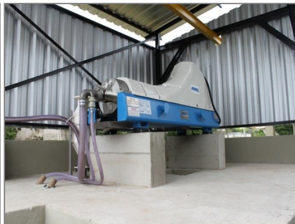
Figura 59 – Centrífuga de desidratação de lodo.
