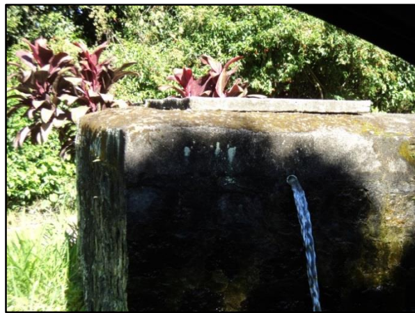
Figura 47 – Unidade de reservação
