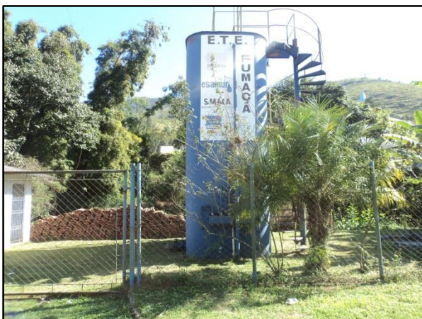
Figura 67 – ETE do distrito de Fumaça
