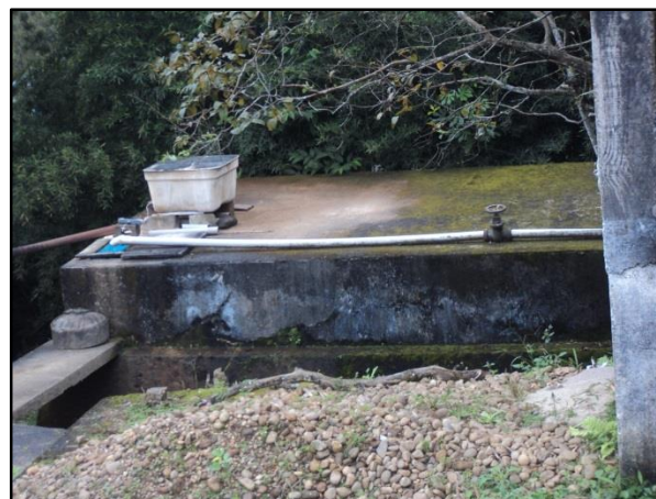
Figura 33 – Vista do tanque para adição de agente desinfetante
