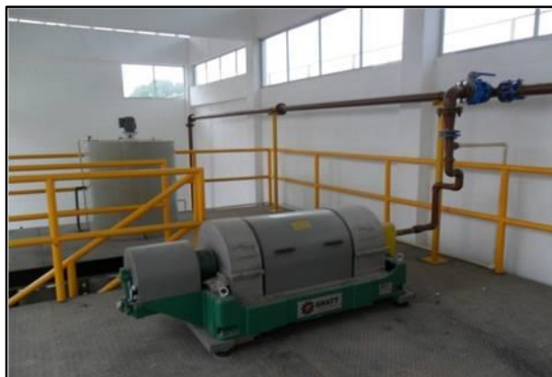
Figura 13 – Área de tratamento de lodo - ETA Alegria
