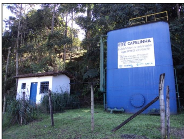
Figura 69 – ETE inoperante do distrito de Capelinha
