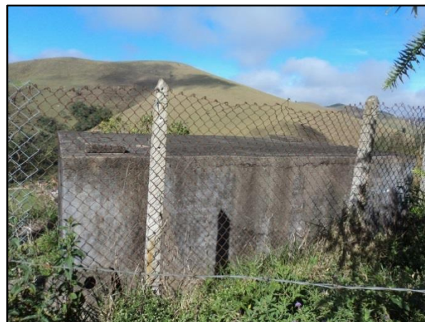
Figura 36 – Reservatório do distrito de Fumaça
