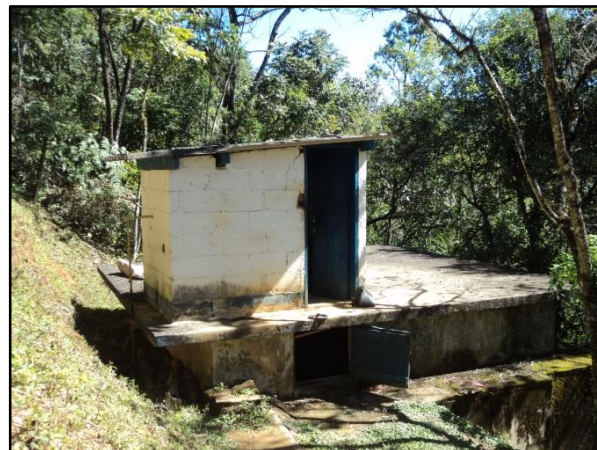
Figura 51 – Unidade de reservação
