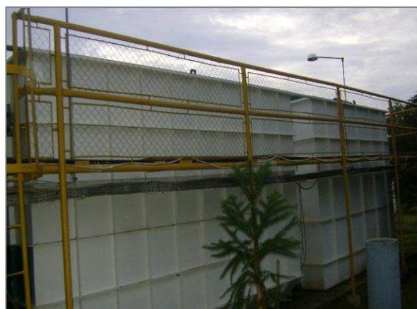
Figura 24 – Unidade de tratamento
