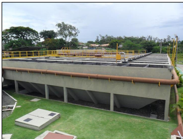
Figura 56 – Reator UASB e biofiltro aerado.
